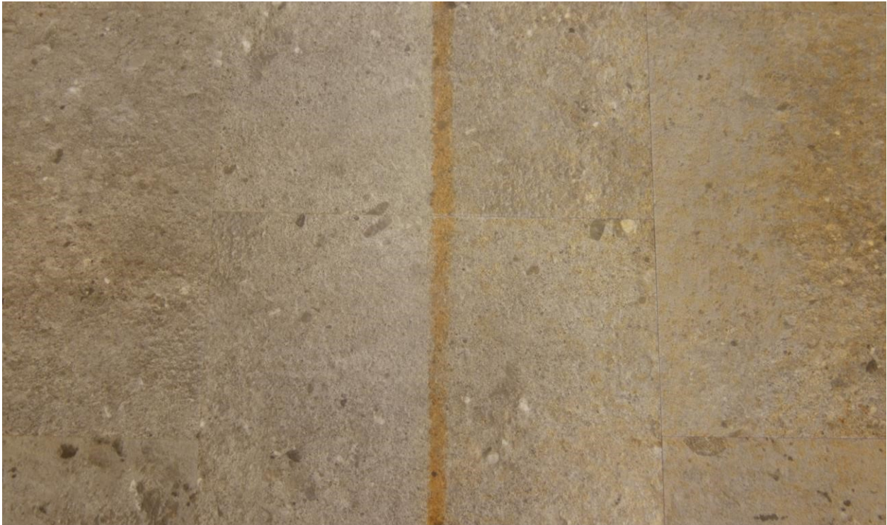
Figure 3 : après 25 fois de nettoyage humide avec une solution teintée de nettoyant désinfectant K ; à gauche PU Sealer satin, à droite non scellé
