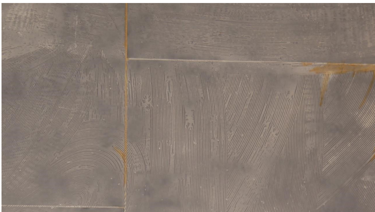
Figure 2 : Pénétration de la solution de PU Cleaner teintée après 5 passages à l'eau sur la moitié non scellée
